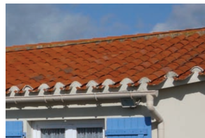
Photo 1 : un schéma à proscrire, la gouttière pendante en doublon avec le système traditionnel
